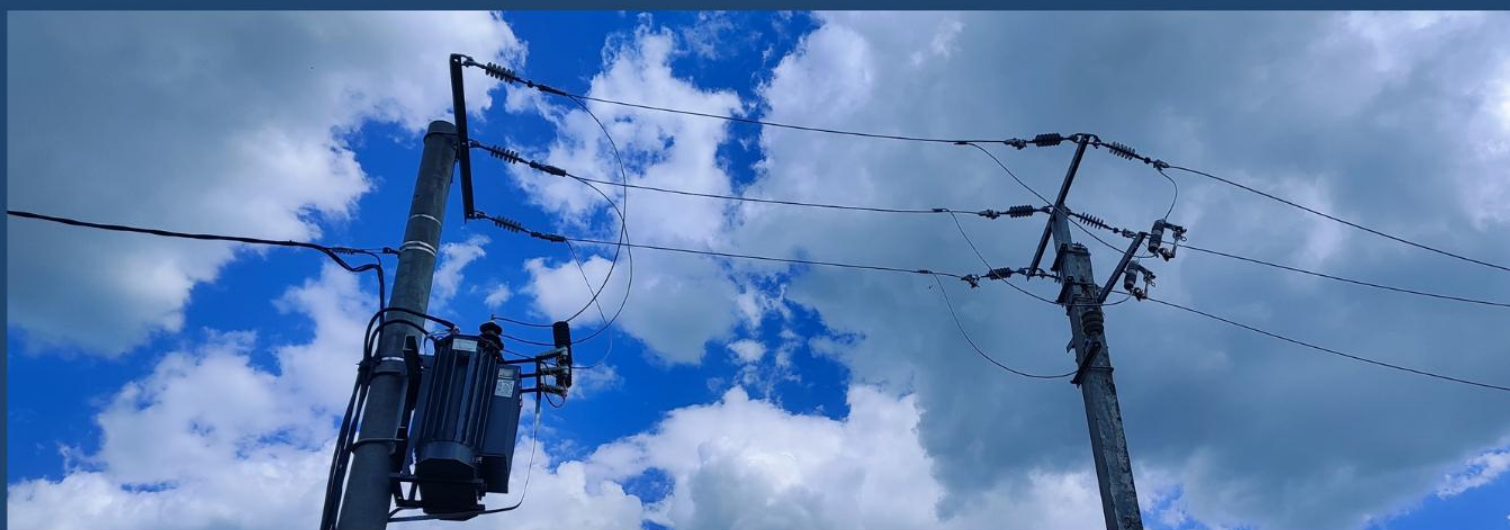
Rețea de distribuție a energiei electrice a Premier Energy în Republica Moldova
