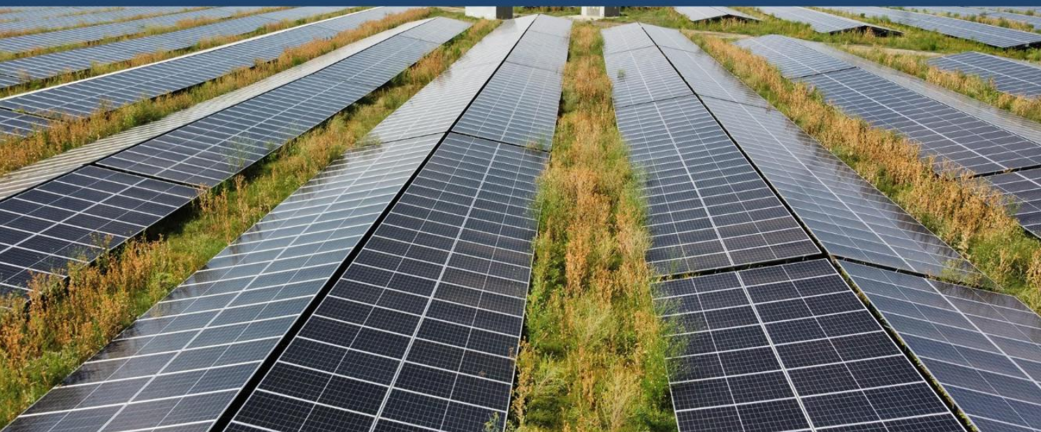
Parcul solar Da Vinci de 26 MW al Premier Energy, cu un sistem de stocare a energiei în baterii de 10 MWh, Nanov, Teleorman, România
