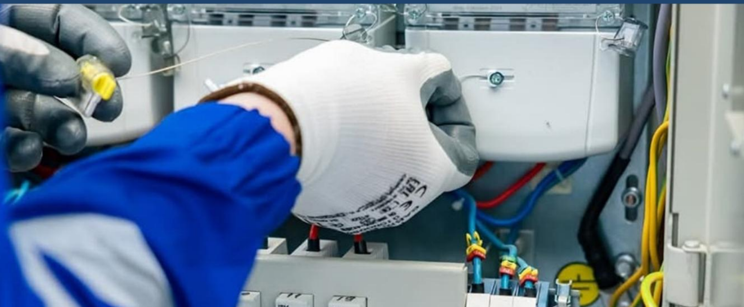
Instalare contoare inteligente ale Premier Energy în Republica Moldova
