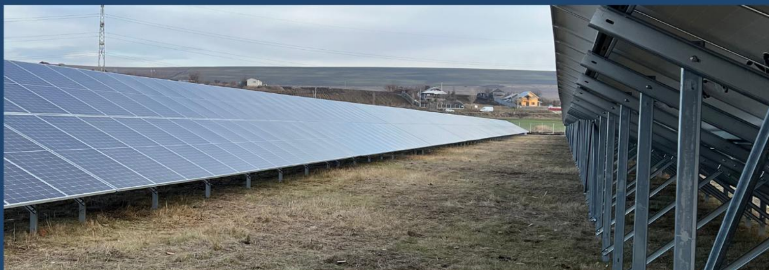
Parcul solar Frumușani de 0,5 MW al Premier Energy, lângă Arad, România
