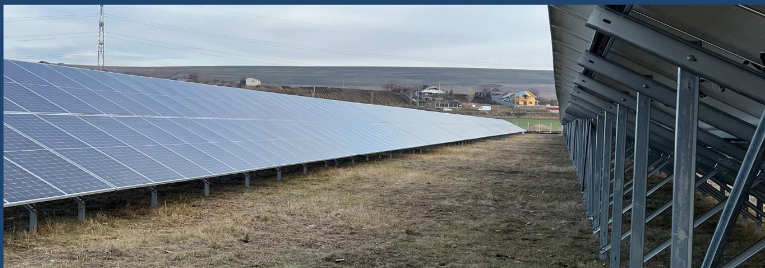
Parcul solar Frumușeni de 0,50 MWp al Premier Energy, lângă Arad, România
